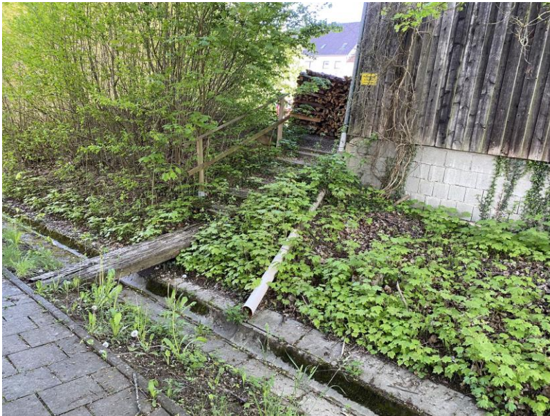
Querrinne für Oberflächenwasser östlich Mayerwirt
