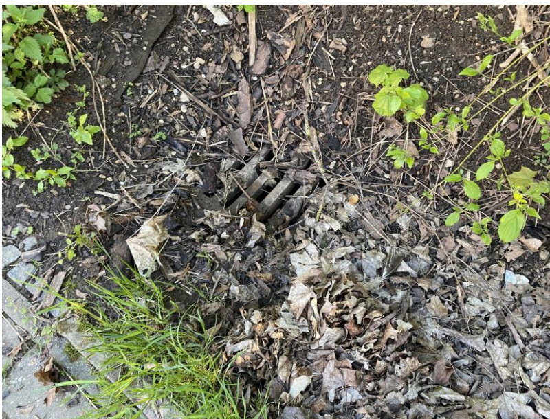
Einlauf nicht ausreichend leistungsfähig für Wasserabfluss
